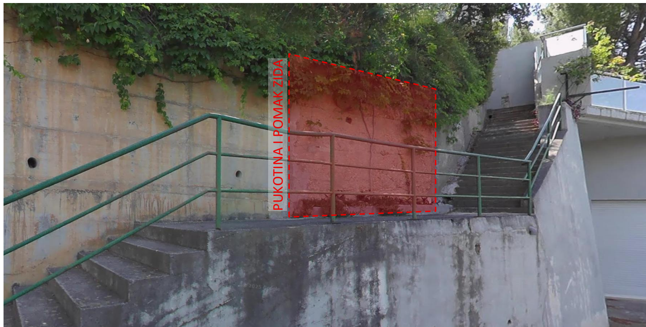
Slika 5 - Potencijalno nestabilni dio zida na profilu 5-5
